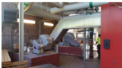
Äldre rökgasfläktar från oljepannorna som kommer rivas ut.
