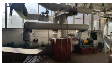
Befintliga distributionspumpar kommer bytas till nya effektivare.
