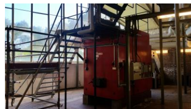
Även denna oljepanna från 1993 kommer att demonteras.
